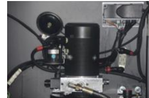
Estación de bombeo de elevación de alta potencia y alto rendimiento
